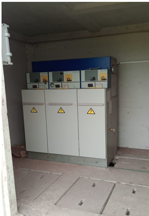
Alimentación celdas de media tensión servicios contra incendios
