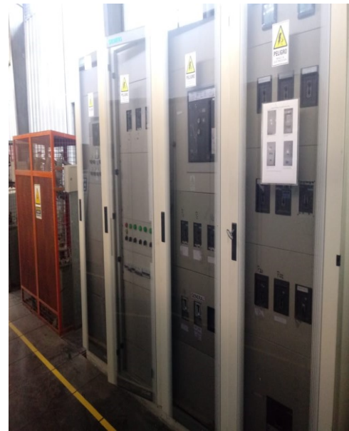
Interruptor acople barras esenciales (Masterpact)
