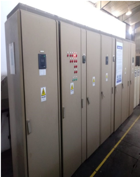
Interruptor de potencia (Masterpact) Trafo 1
