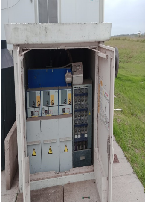
TGBT lado tierra (carga terminal)
