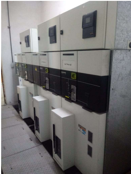
Alimentación celdas media tensión
