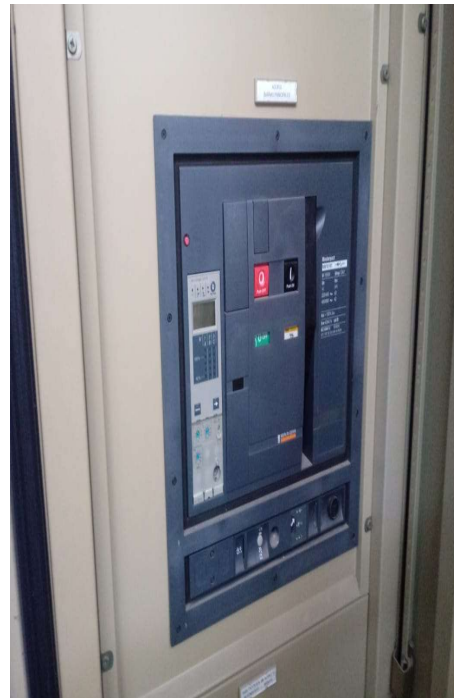
Interruptor acople barras esenciales (Masterpact)
