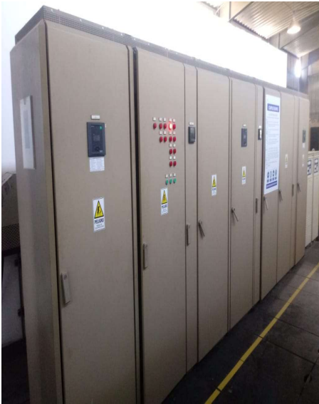
TGBT lado tierra (carga terminal)
