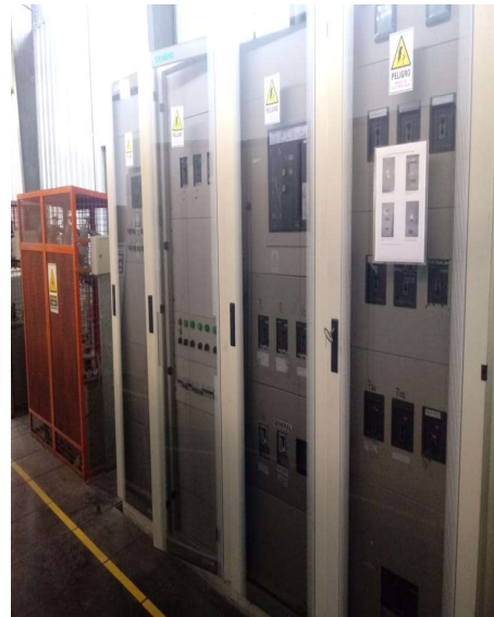
TGBT lado aire (carga operativa)
