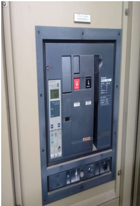
Interruptor de potencia (Masterpact) Trafo 1
