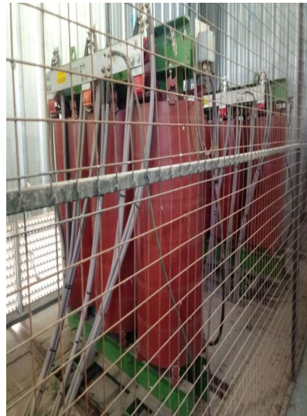
Subestación transformadora – Trafos de 1000 KVA
